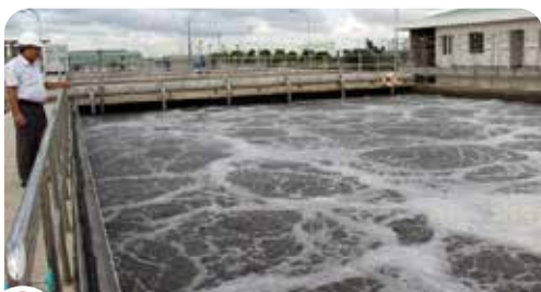
27 Xử lý nước thải – Sóc Trăng
